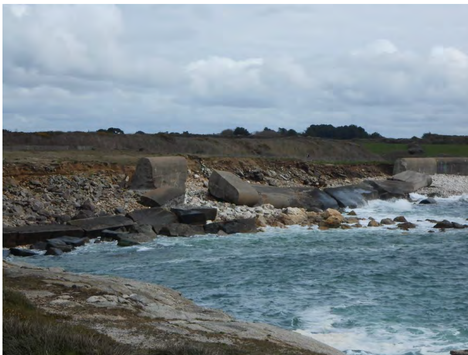
Illustration 10 : Dommages au « Mur de l'Atlantique » sur la partie Nord de l'anse du Courégant (photo : BRGM, avril 2018)
