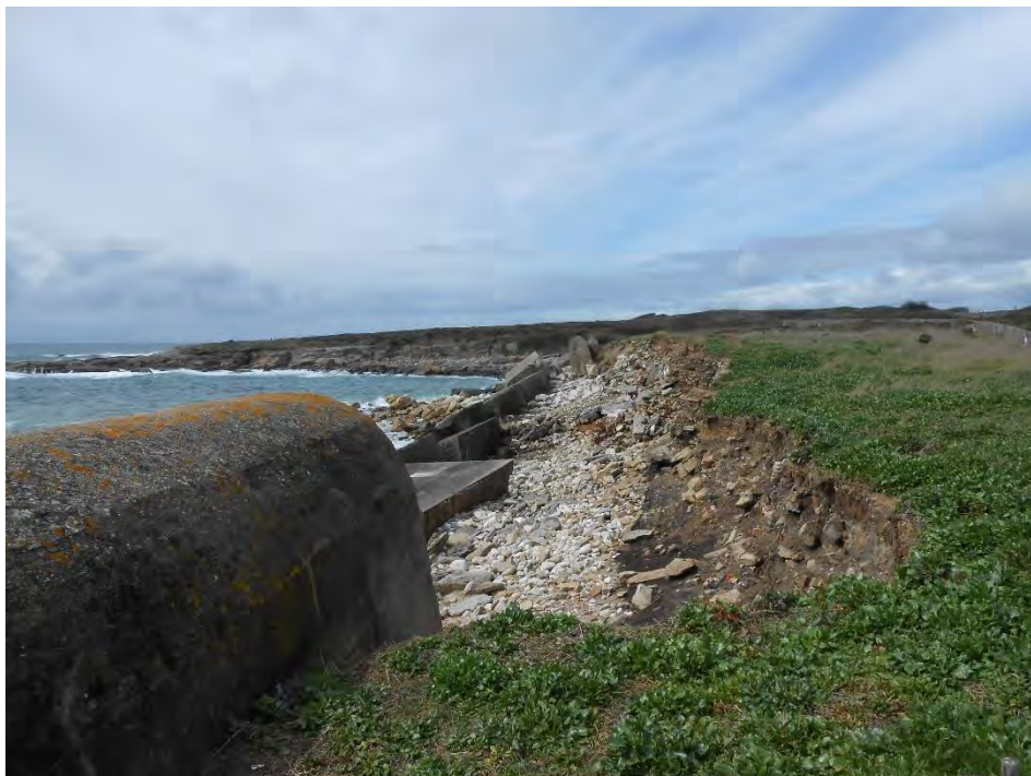
Illustration 11 : Erosion en arrière du « Mur de l'Atlantique » sur la partie Nord de l'anse du Courégant (photo : BRGM, avril 2018)
